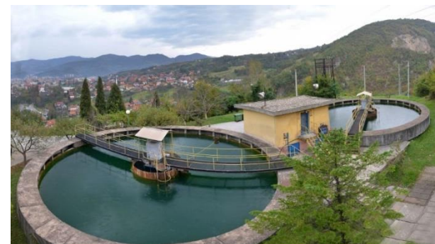
Slika 15. Postrojenje za otpadne vode
